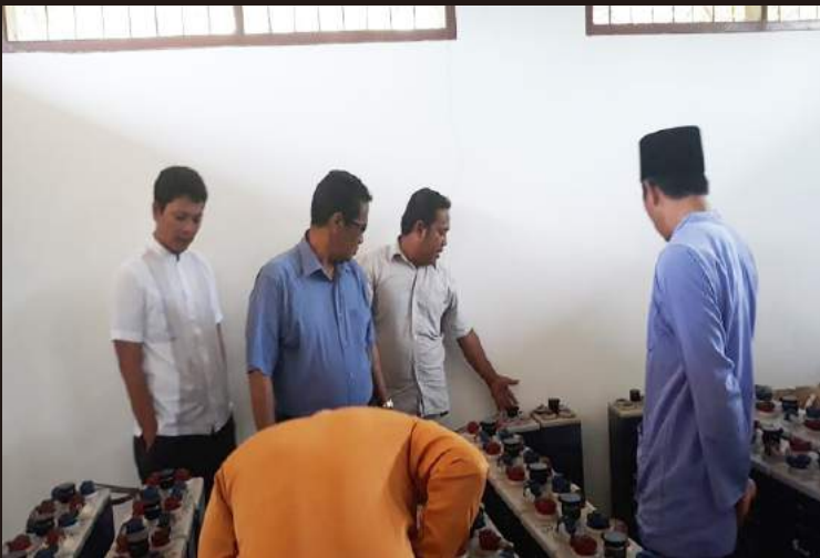
Anggota DPRD Anambas, M Da'i dan Raja Bayu melihat kondisi peralatan PLTS desa Batu Belah
